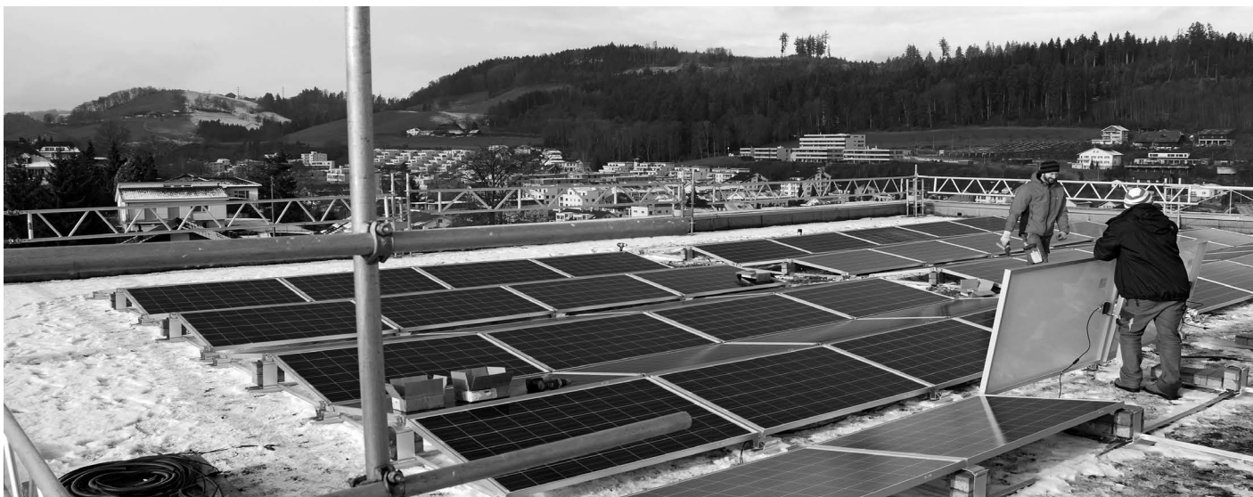
Die Solaranlage auf dem Dach der HPS setzt ein Zeichen für die Förderung erneuerbarer Energie.
