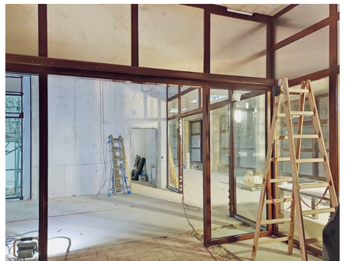
Die Fenster zwischen der Galerie und der Sporthallen Hallenbad werden im Februar 2025 ausgebaut.
